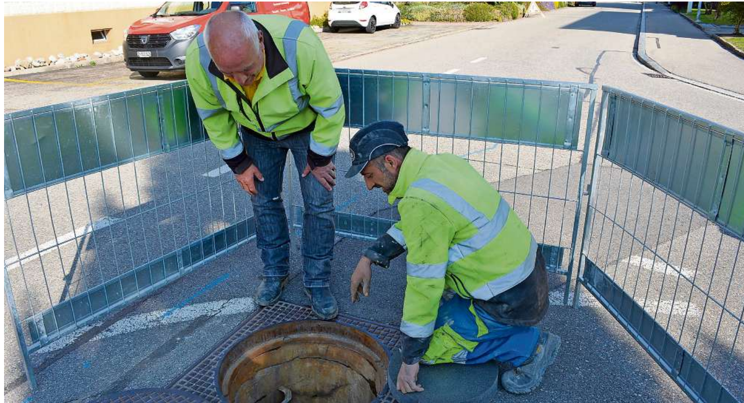
Von oben nach unten: Werner Renggli (links) und sein Mitarbeiter begutachten einen Schacht an der Bahnhofstrasse Kollbrunn.
